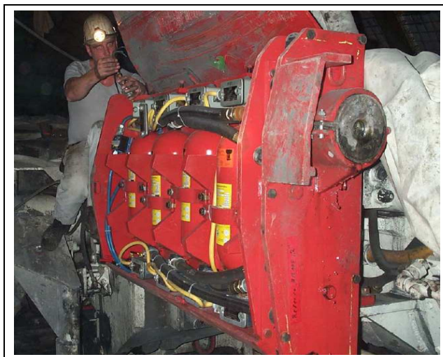
Fotografía C.3 Sistema de extinción automática instalado en un minador
